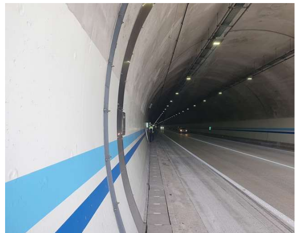
위 치 측벽부 현 황 전경
